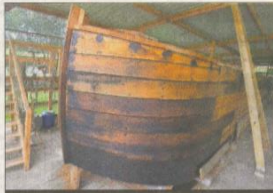
CHANTIER. La Belle de Grignon sera mise à l'eau en 2017. Il ne restera plus qu'à finir l'intérieur, et elle pourra naviguer.
